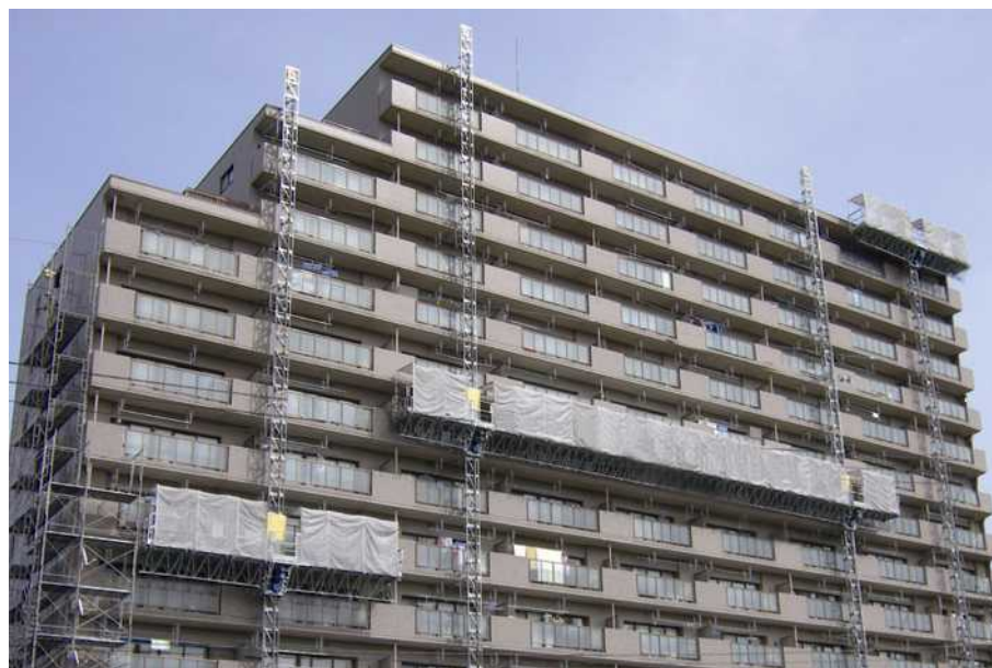
ツインマスト1基+シングルマスト2基を併用したマンション修繕工事 (宮城県仙台市 / 施工: 仙建工業)
