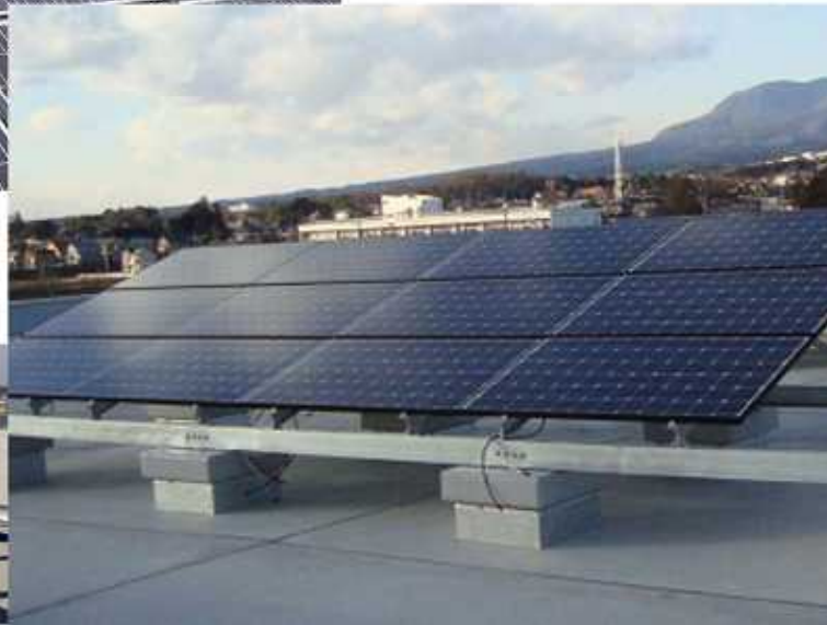
太陽光パネル架台
