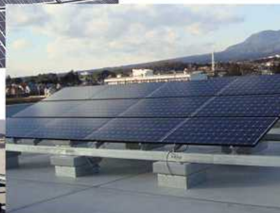
太陽光パネル架台
