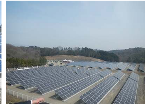
太陽光発電システム
