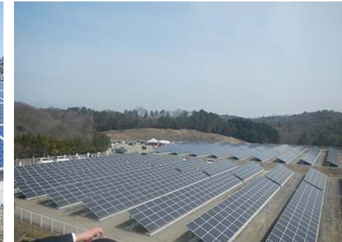
太陽光発電システム
