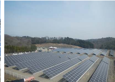
太陽光発電システム
