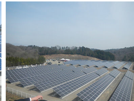
太陽光発電システム
