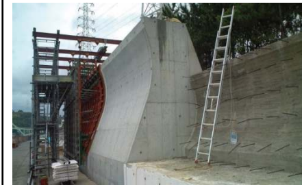
港湾（防潮堤等） 高波、高潮、津波被害を防ぐ防潮堤の建設工事
