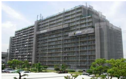
高層建物維持補修工事 超高層建物の維持補修・メンテナンス、解体等
