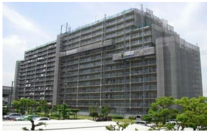
高層建物持補修工事 超高層建物の維持補修・メンテナンス、解体等
