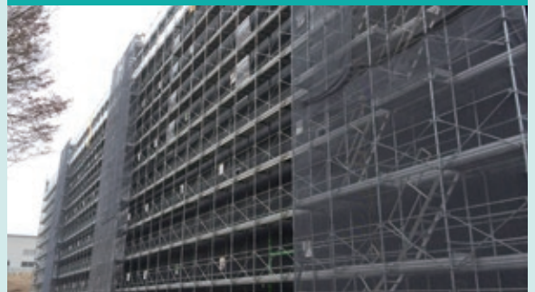
主に建築物の外壁面に沿って設営される作業用の足場
